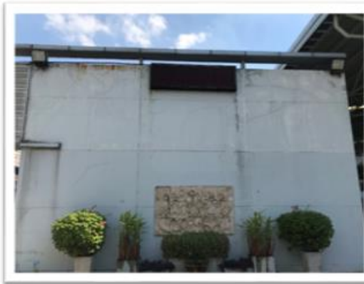
ก่อนปรับปรุง
